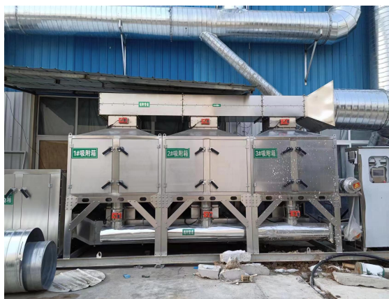
4#活性炭吸附/脱附+催化燃烧装置
