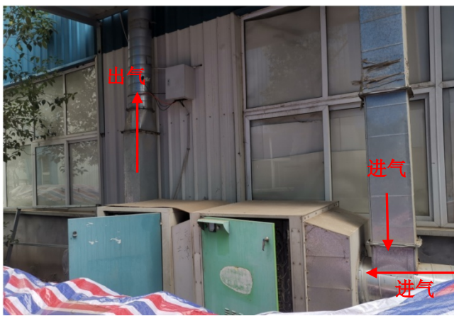
依托现有废气处理措施
