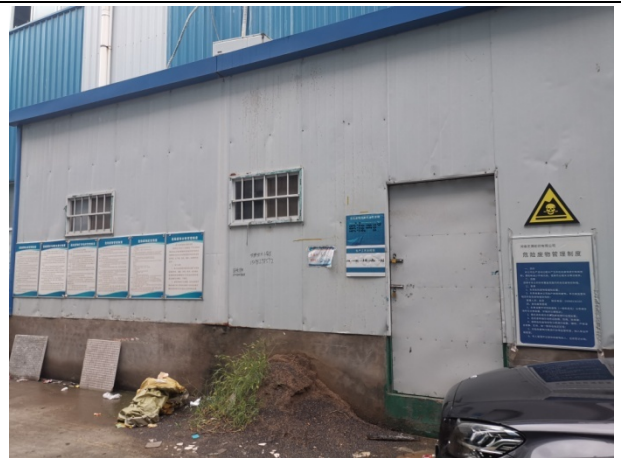
依托现有工程危废暂存间
